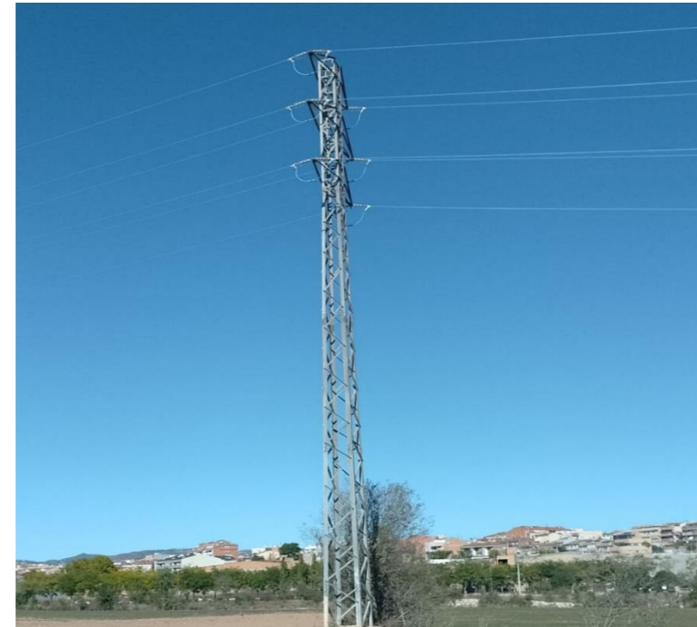
Fotografia 3. TORRE DE MT D'ON IX NOU SUMINISTRAMENT
