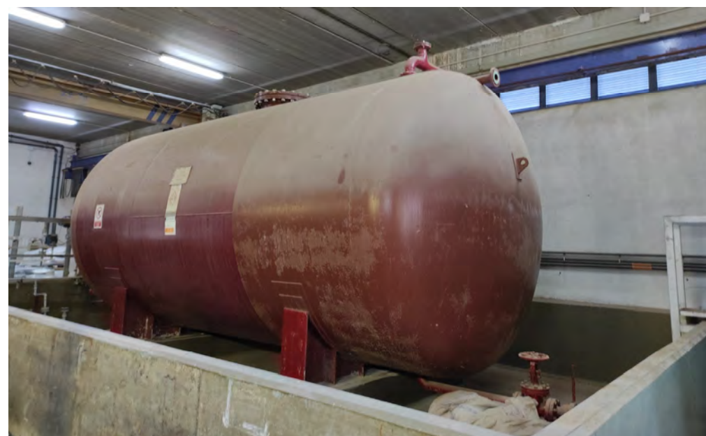
Fotografia 2. Dipòsit àcid sulfúric.
