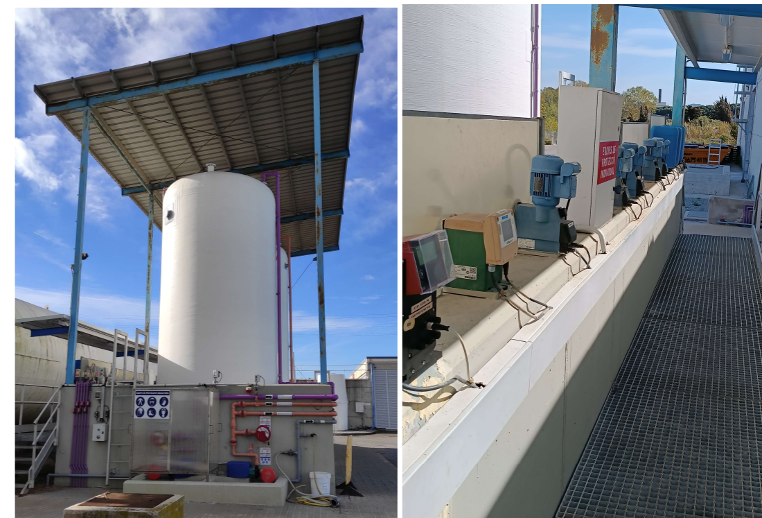
Fotografia 15. Dipòsit d'hidròxid sòdic i el sistema de dosificació.
