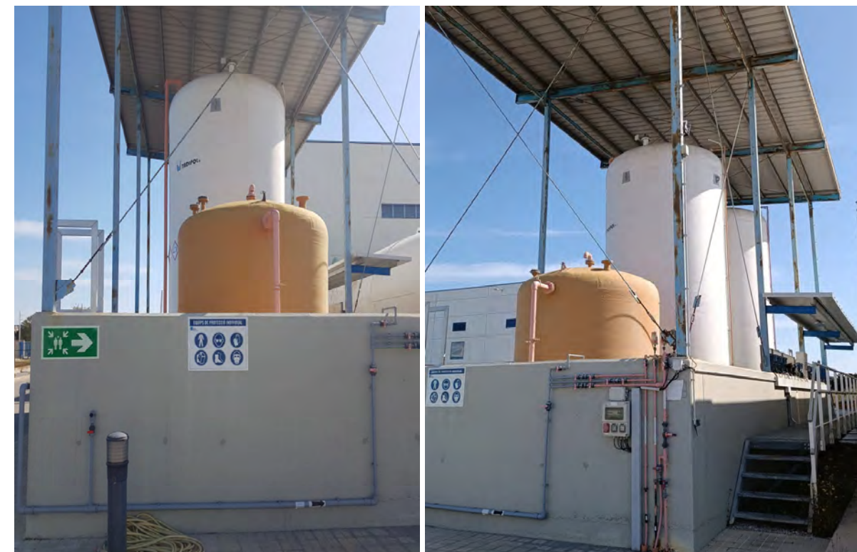
Fotografia 14. Dipòsits de hipoclorit sòdic.
