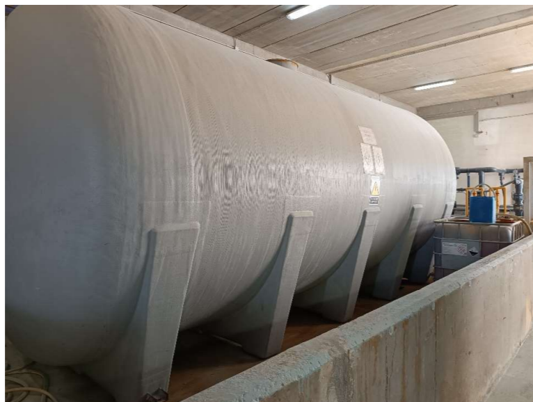
Fotografia 3. Dipòsit clorur fèrric.
