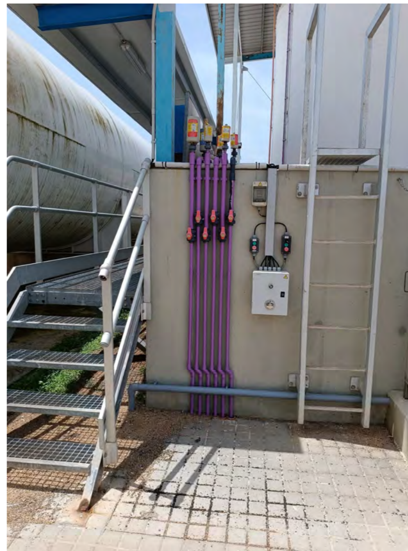
Fotografia 25. Canalitzacions de sosa.
