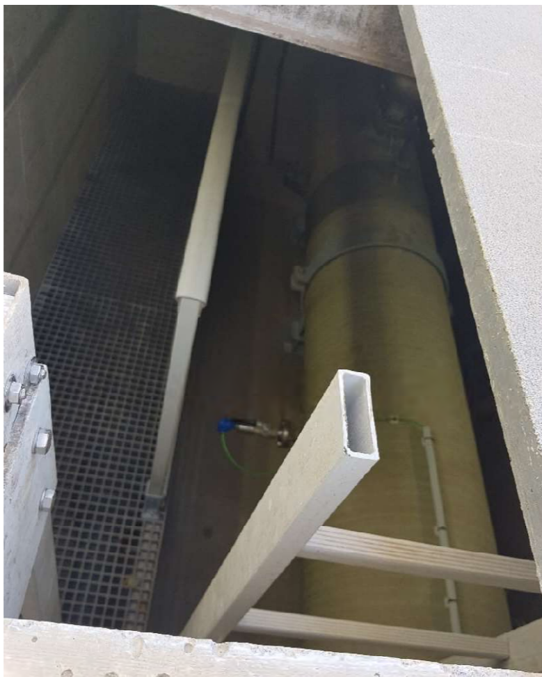
Fotografia 17. Canonada d'alta pressió, sortida d'osmosi inversa.
