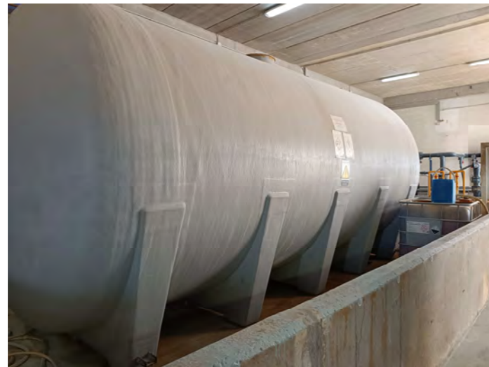
Fotografia 2. Dipòsit actual de clorur fèrric.
