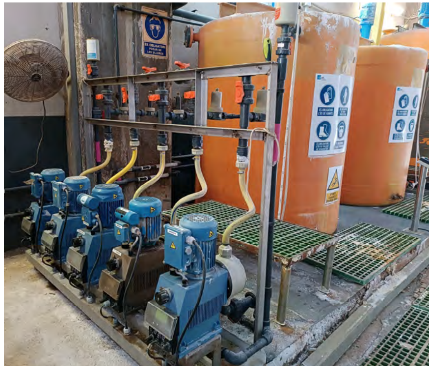
Fotografia 5. Dipòsits de metabisulfid sòdic.
