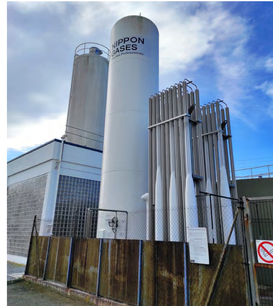
Fotografia 12. Sistema de diòxid de carboni.
