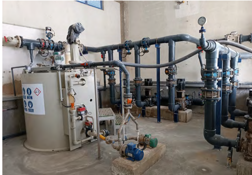
Fotografia 10. Cuba de preparació per a la lletada d'hidròxid càlcic instal·lada a l'ampliació del 2010.
