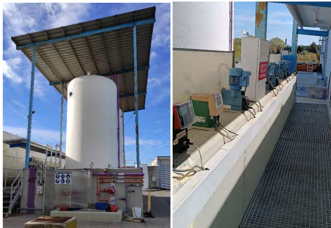
Fotografia 14. Dipòsit d'hidroxid sòdic i el sistema de dosificació.
