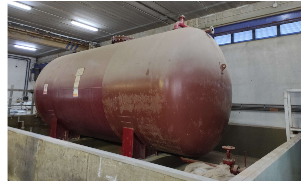
Fotografia 2. Dipòsit àcid sulfúric.
