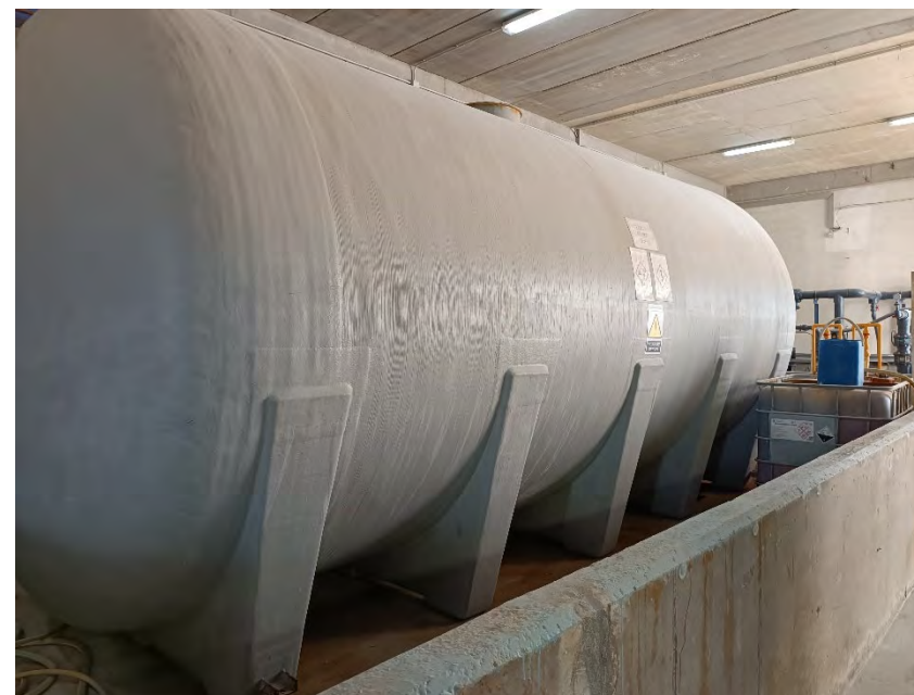
Fotografia 3. Dipòsit clorur fèrric.
