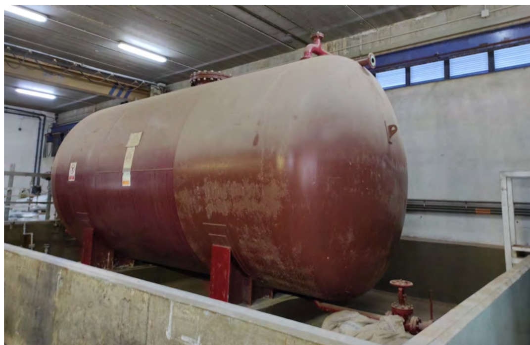
Fotografia 1. Dipòsit àcid sulfúric.
