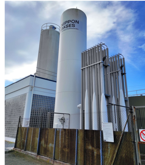
Fotografia 12. Sistema de diòxid de carboni.
