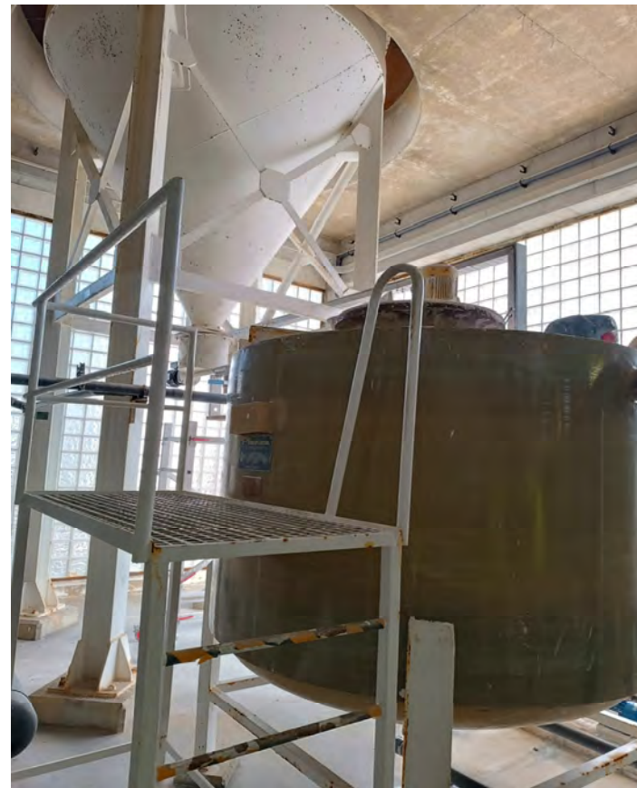
Fotografia 11. Sitja i saturador de calç per a la lletada d'hidròxid càlcic original.
