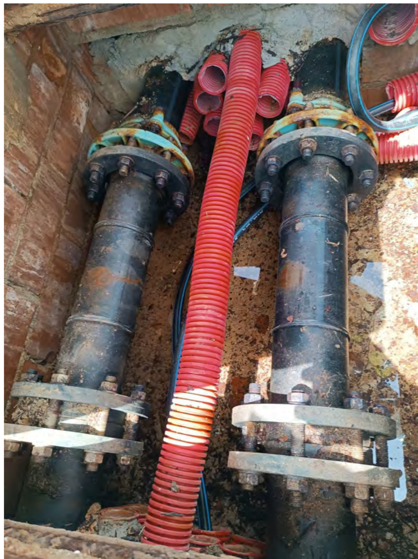
Fotografia 24. Arqueta canalitzacions químics (CO 2 i hipoclorit sòdic) situada al costat del pòrtic.
