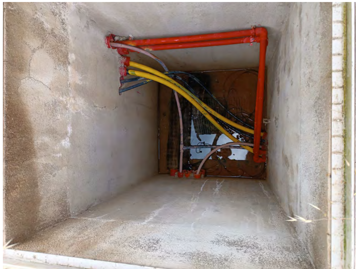
Fotografia 20. Arqueta canalitzacions químics, previ a la 1era filtració.
