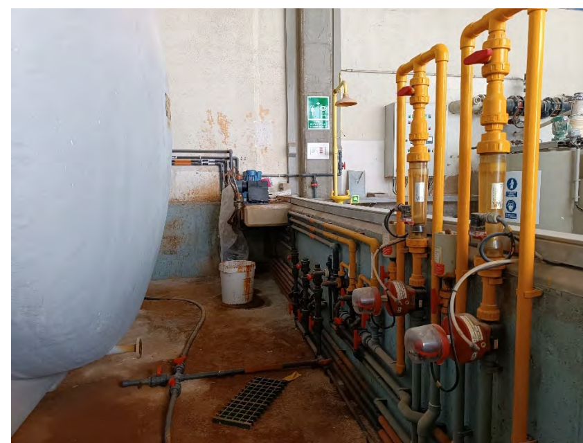
Fotografia 4. Sistema dosificació clorur fèrric.
