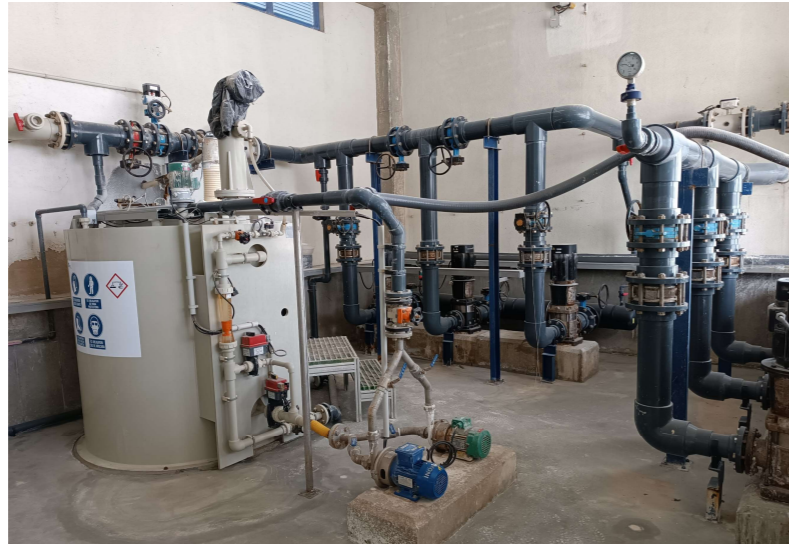
Fotografia 10. Cuba de preparació per a la lletada d'hidròxid càlcic instal·lada a l'ampliació del 2010.
