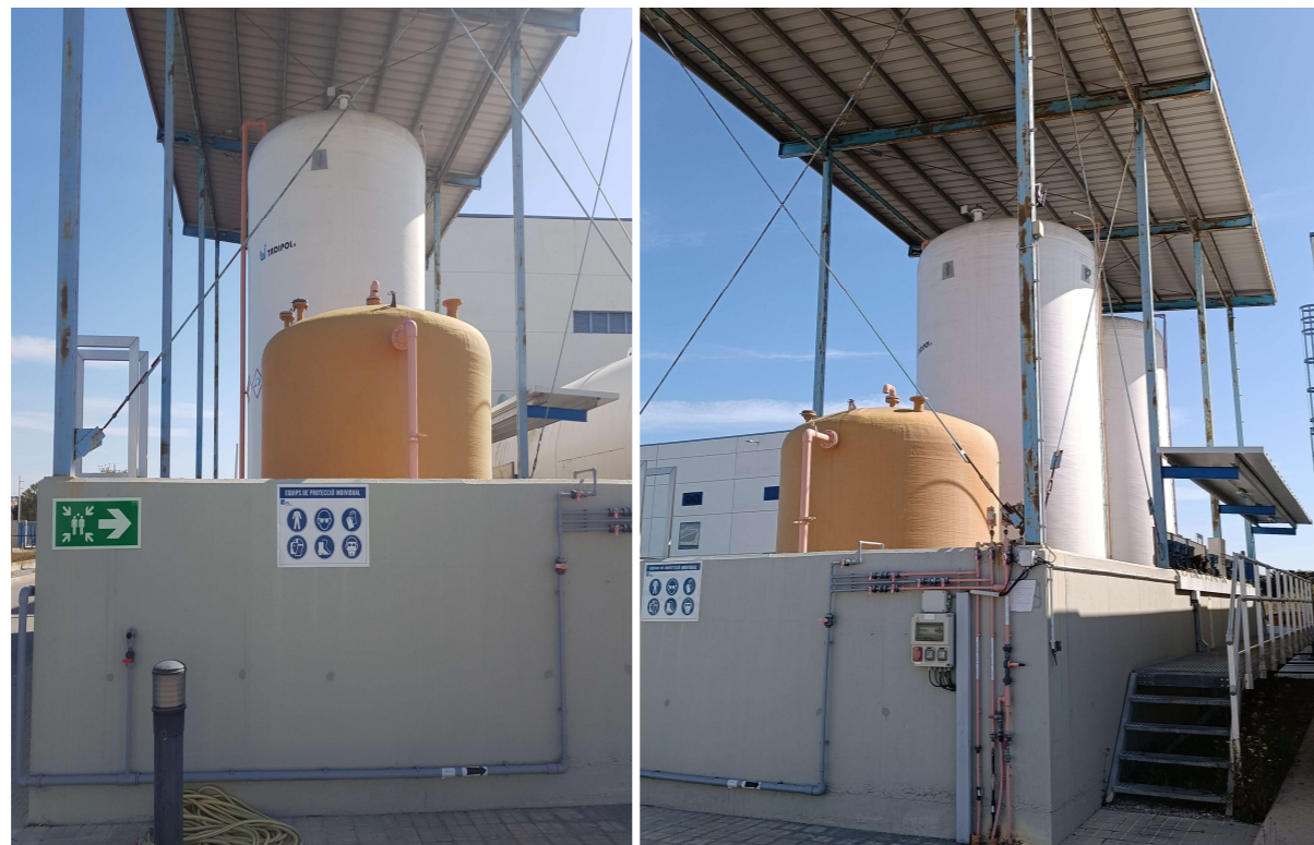
Fotografia 14. Dipòsits de hipoclorit sòdic.
