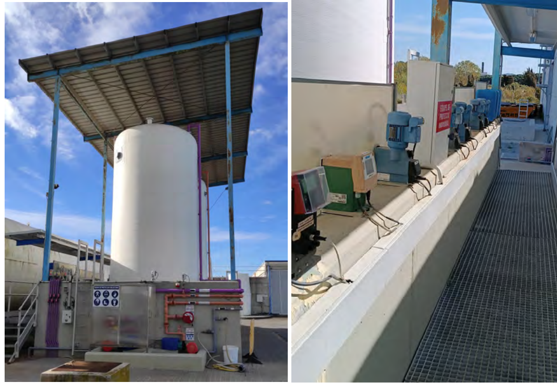
Fotografia 15. Dipòsit d'hidròxid sòdic i el sistema de dosificació.
