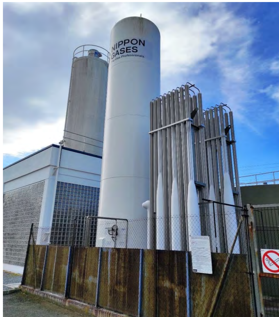
Fotografia 11. Sistema de diòxid de carboni.
