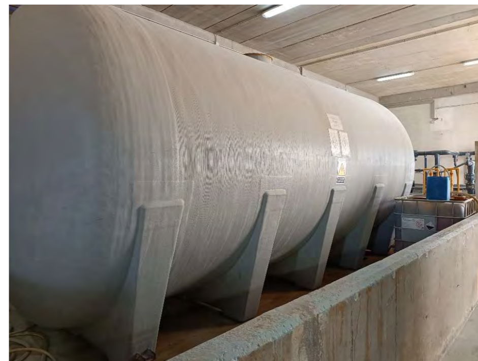
Fotografia 2. Dipòsit clorur fèrric.
