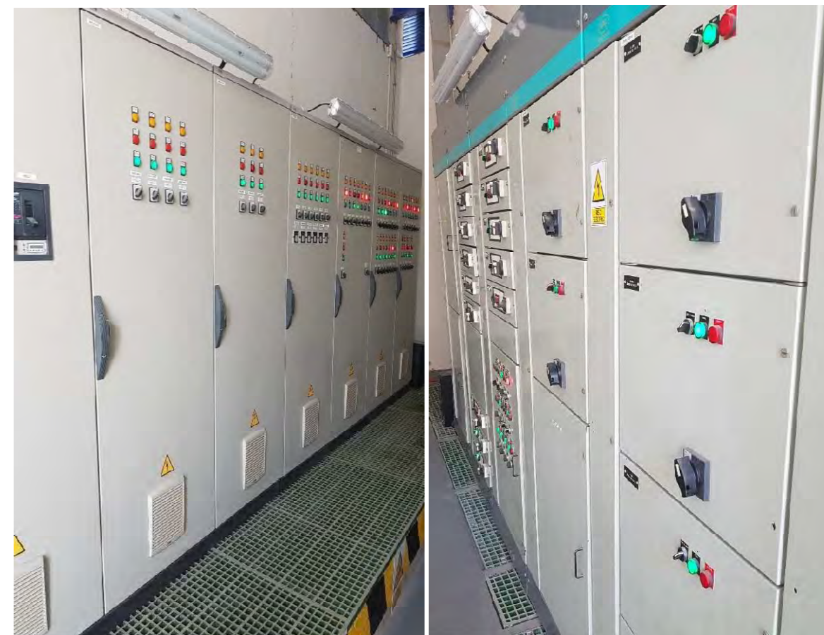
Fotografia 16. Vista general de la sala de quadres elèctrics i control.
