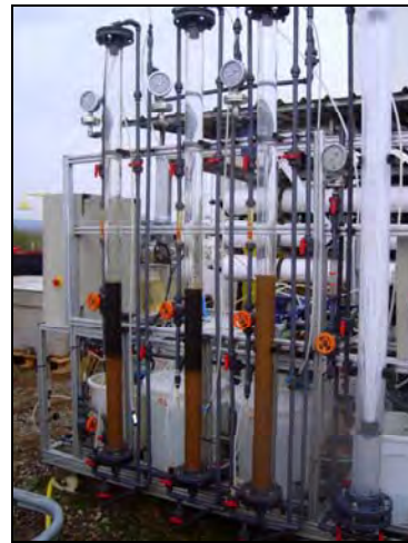
Ilustración 1 Planta piloto transportable de pretratamientos.
