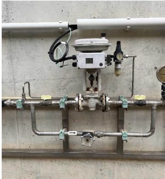
Foto 13. Vàlvula dosificadora de CO 2 , de la línia A de remineralització. Ubicada en la façana exterior sud.
