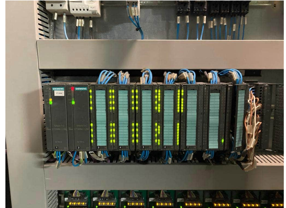
Foto 4. Ocupació de la remota existent en l'armari 07 PLC 6C01 (Línia B, Llits Calcita 17-32).
