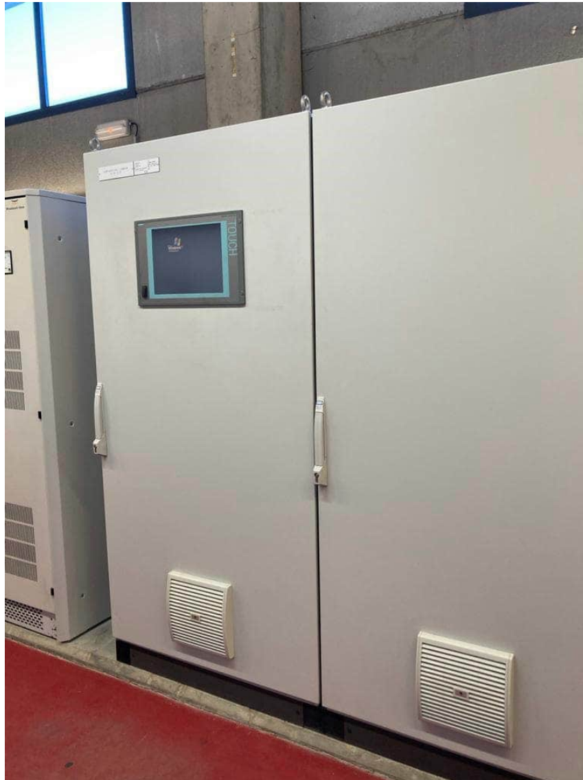
Foto 7. Armari 07 PLC E2 01, amb el PLC de Bombeig d'Aigua Producte i les estacions màsters dels equips Rotork.
