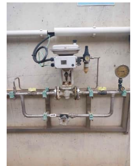
VÁLVULA DE DOSIFICACIÓ DE CO2 A SUBSTITUIR
