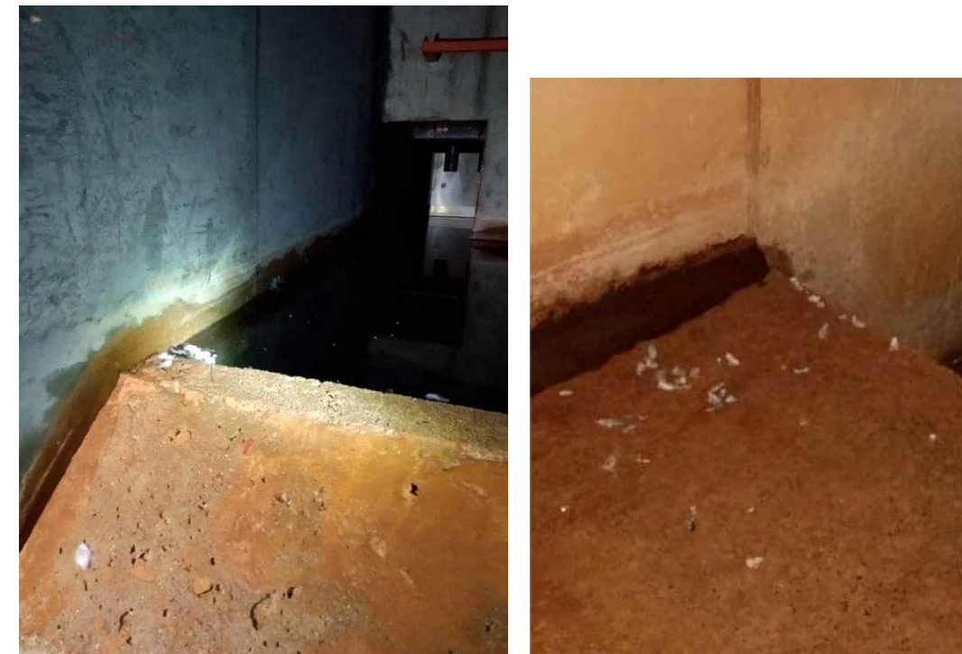
Plomes al sobreexidor de sortida d'un llit
