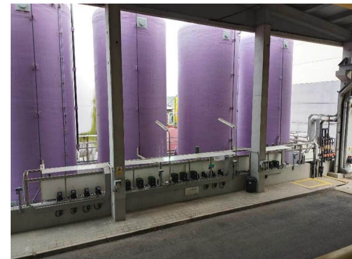
Foto 10. Façana Nord. Vial de descàrrega de la calcita i instal·lacions de dosificació de sosa.
