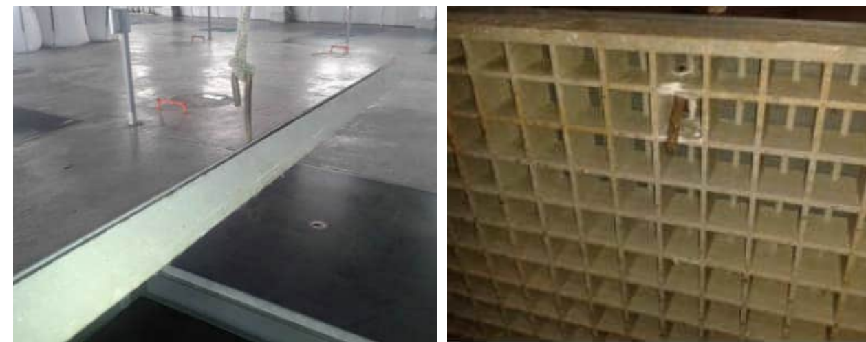
Foto 3. Aixecament d'una tapa i detall deteriorament del costat intern del tramex. (Font: ATL)
