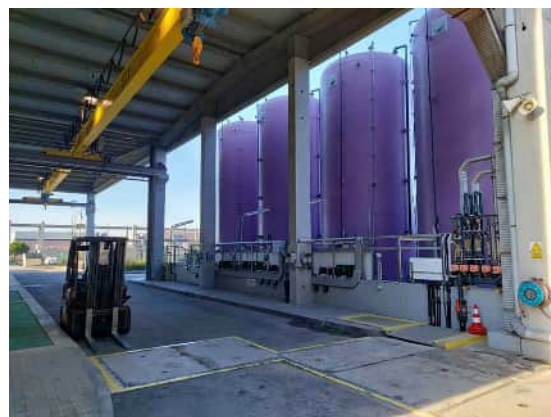
Vial de descàrrega de calcita i dosificació de sosa
