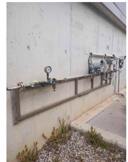
SISTEMA DE DOSIFICACIÓ DE CO2 ACTUAL
