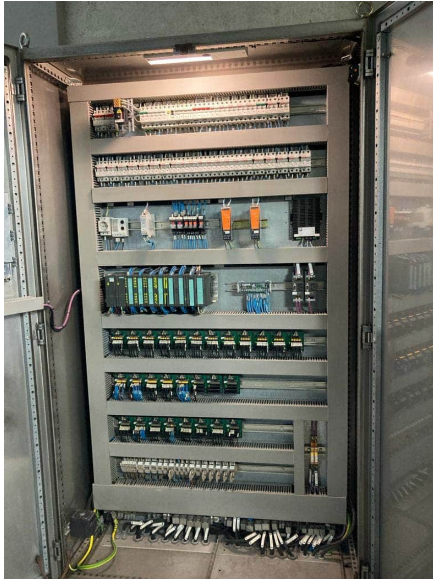
Foto 1. Ocupació de l'armari existent 07 PLC 6A01 (Línia A, Llits Calcita 1-16).
